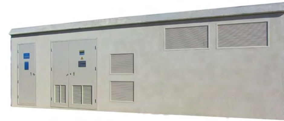
Figure 80. Exemple d'un local de transformation
