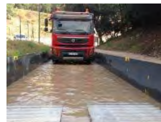
Plateforme de nettoyage des roues
