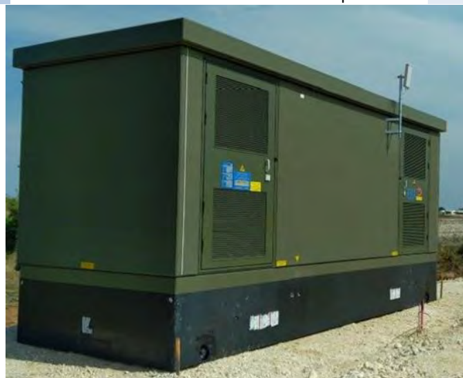
Figure 79. Exemple de poste de livraison
