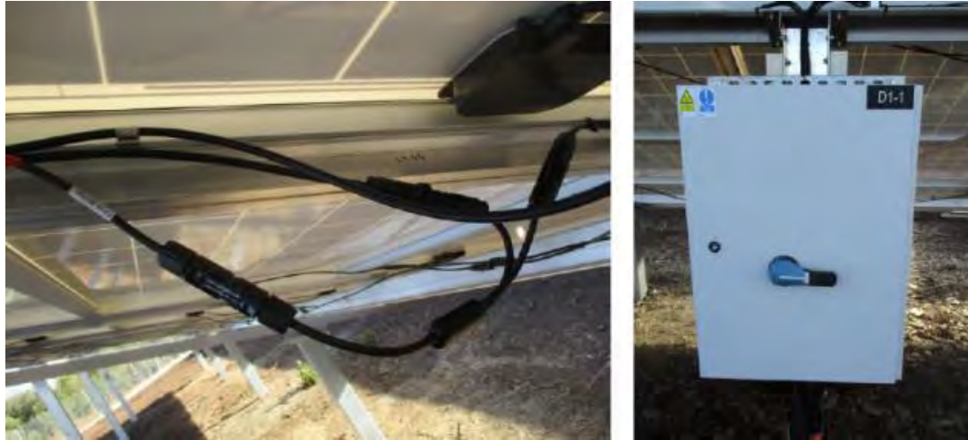
Photo 30. Exemple de câble électrique et de boîte de raccordement
