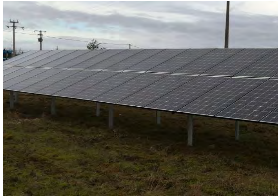
Photo 28. Exemple de structure fixe
